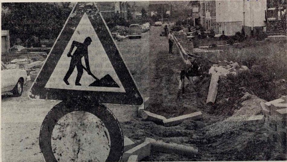
DIE BEWOHNER des Neubaugebietes in Nackenheim können sich freuen: Die Mittel für Kanal- und Straßenbau wurden jetzt bewilligt, so daß mit den Arbeiten begonnen werden konnte.
